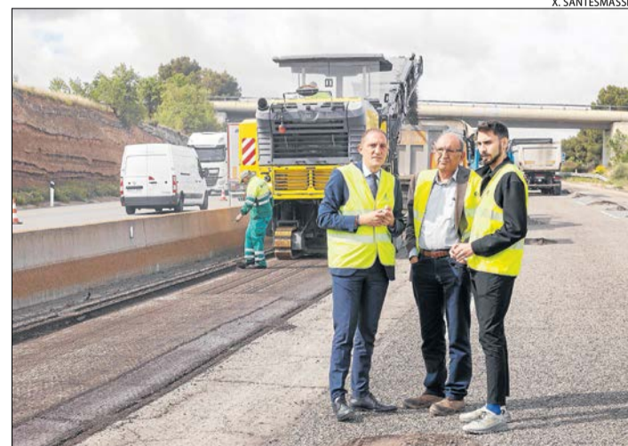
Obres a l'A-2 a Granyanella ■ Fins dilluns vinent estarà tallat un carril, en sentit Lleida, de la variant de Cervera a l'A-2 a Granyanella, un tram de tres quilòmetres entre els punts 512 i 515. Es desvia el trànsit per la via de servei.
